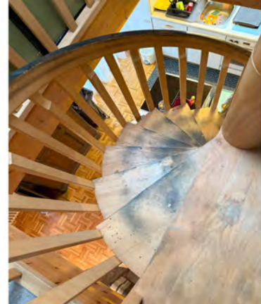
Treppe OG verschmutzt
